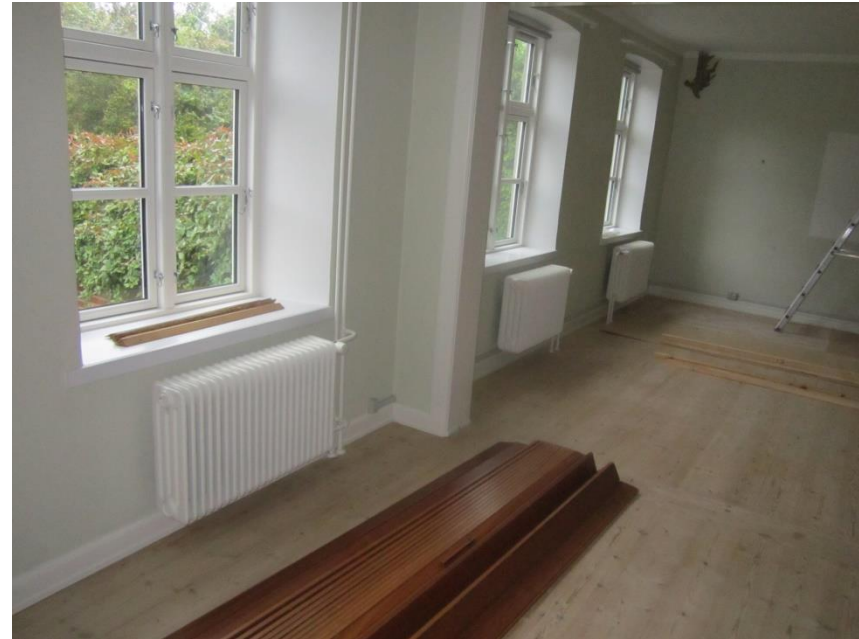
Radiatorer i samme rum skal indstilles til samme værdi på termostatventilerne.
