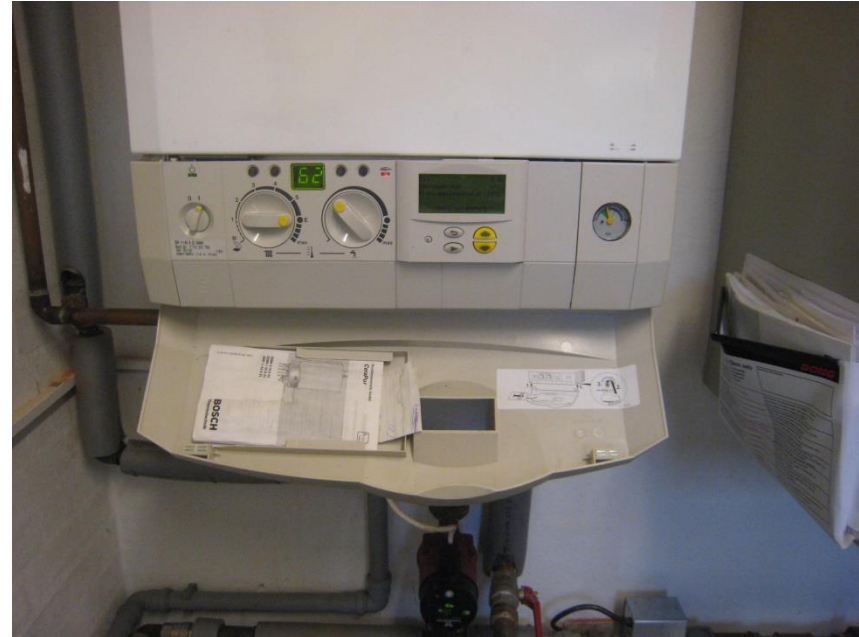
Betjeningspanel på en naturgaskedel. Fremløbstemperaturen reguleres automatisk efter udetemperaturen og vises i displayet.
