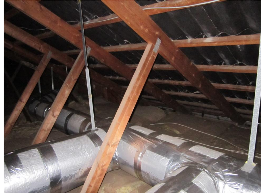
Mekaniske ventilationsanlæg er normalt installeret i ubenyttede tagrum.
